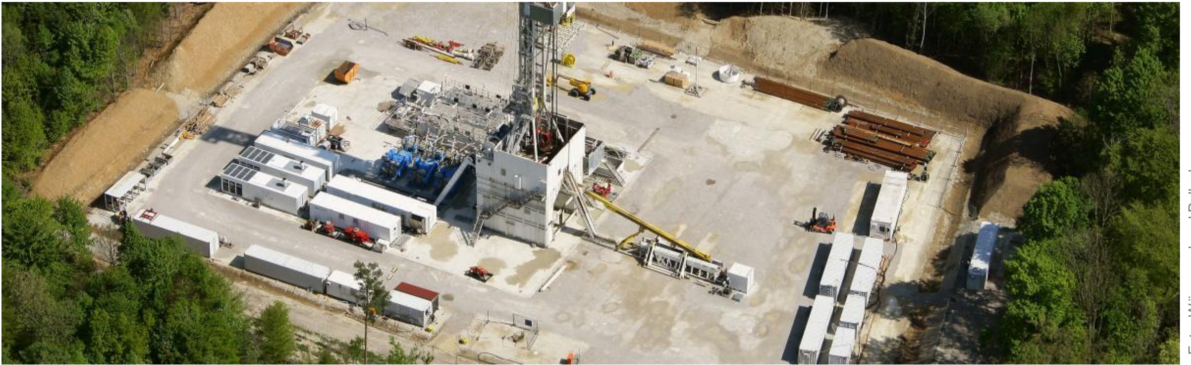
Foto: Wärmeverbund Pullach
